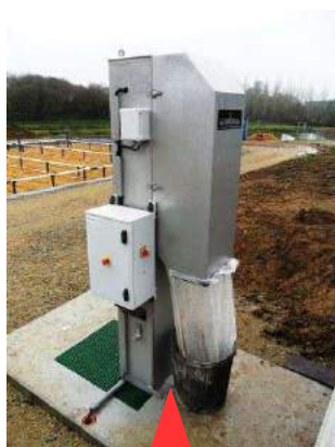
Dégrilleur de la station d'épuration
