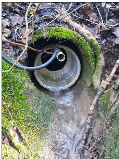
Figure 4 : Exutoire Ouest - Manchon déversoir DN 250 mm
