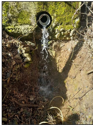
Figure 2 : Exutoire Est - Manchon déversoir DN 300 mm
